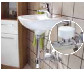
DN15 am Siphon
